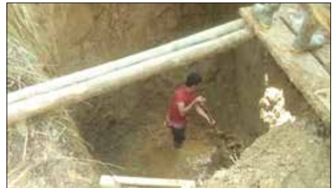
Die Zisterne für das Abwasser
